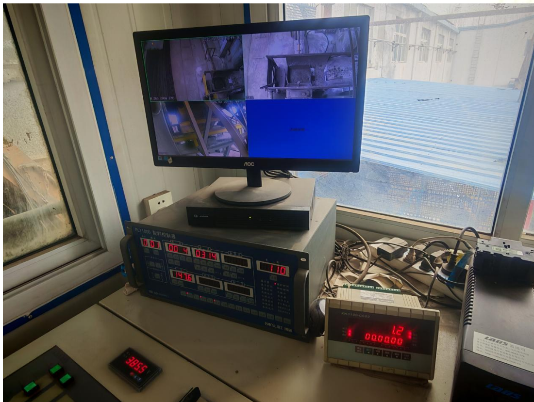
水泥余浆收集搅拌系统
